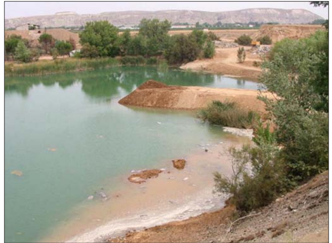
Aspecto del dique provisional en construcción en la cubeta oriental de la gravera, para reducir después la profundidad de la cubeta con esos mismos materiales y construir una isla naturalizada.
