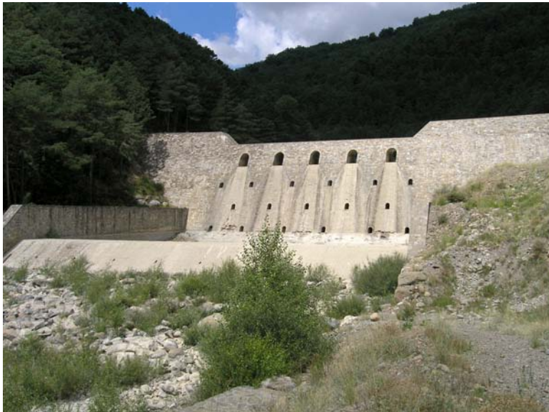
Presas de retención de sedimentos en el barranco de Arás (Pirineo aragonés). Foto: Alfredo Ollero
