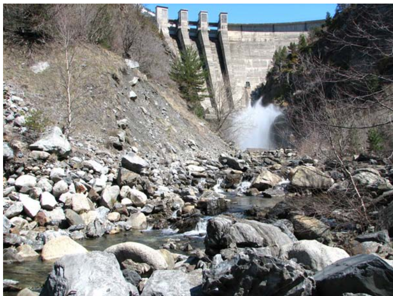
Acorazamiento de bloques al pie de la presa de Paso Nuevo (río Ésera). Foto: Daniel Mora
