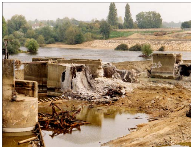
Trabajos de desmantelamiento en octubre de 1998. Foto: Roberto Epple, European Rivers Network (ERN)
